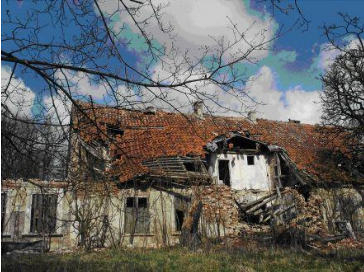
Fot. 8 Oterki. Zdewastowany budynek dworu
